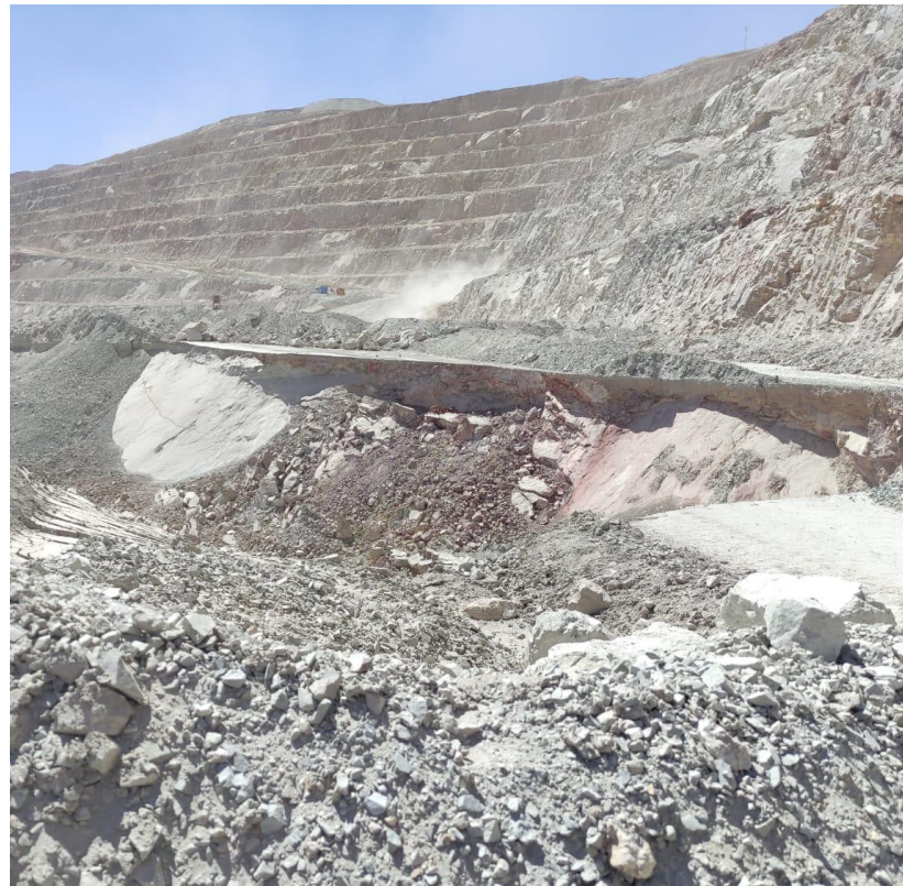
El gigantesco socavón en la Rampa PL1 fue uno de los graves incidentes ocurridos en 2022.
